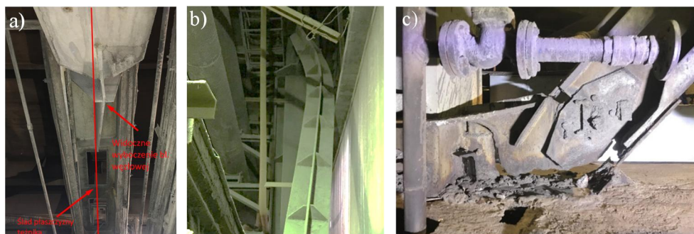
Rys. 3. Uszkodzenia stężeń konstrukcji: a) wybrzdzona blacha węzłowa; b) wybrzdzone stężenie; c) zerwane połączenie stężenia.
